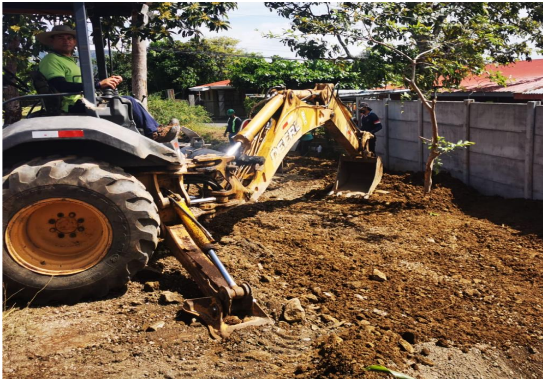
Zanjón Margarita Penón
