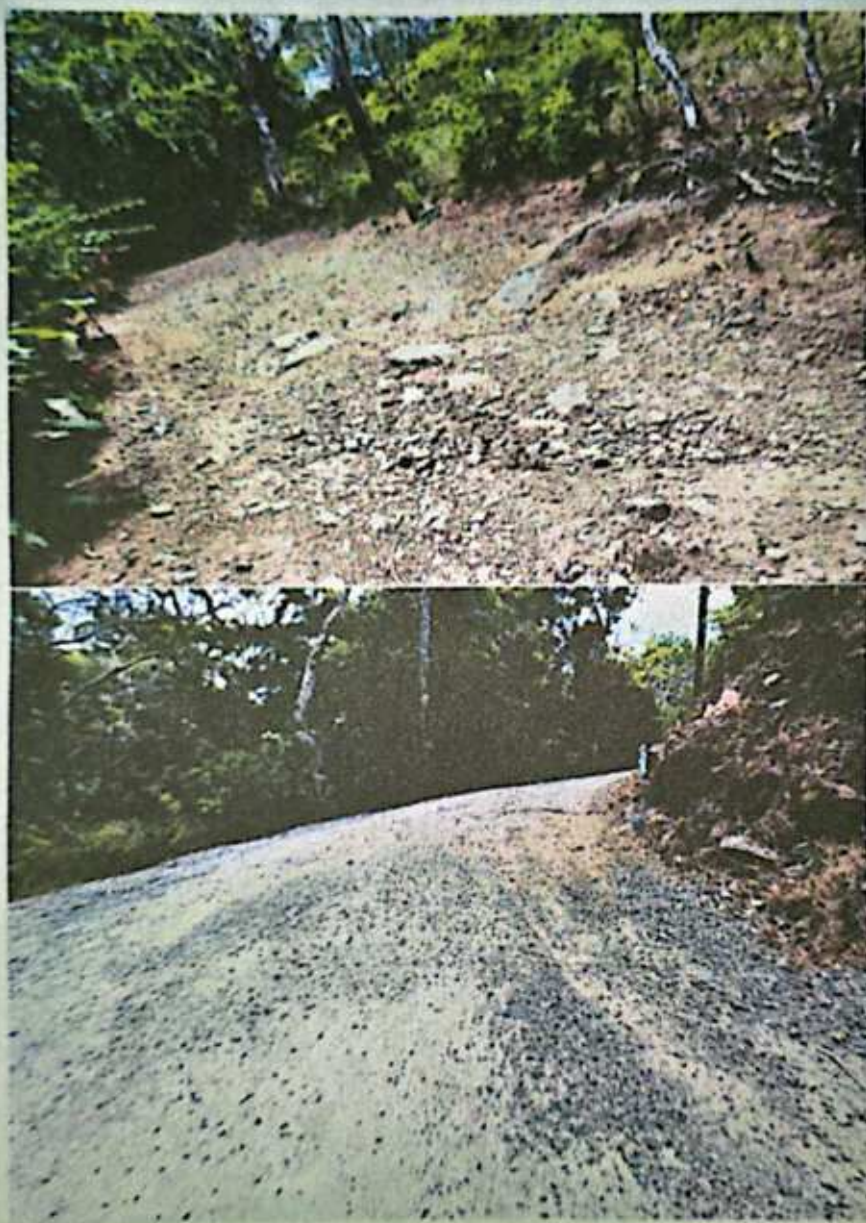
Fotografías del estado de la calle Los Moras - 2025
